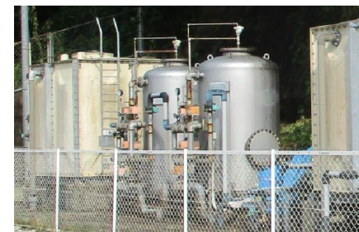
※原水質に合わせたろ過装置を設置します
